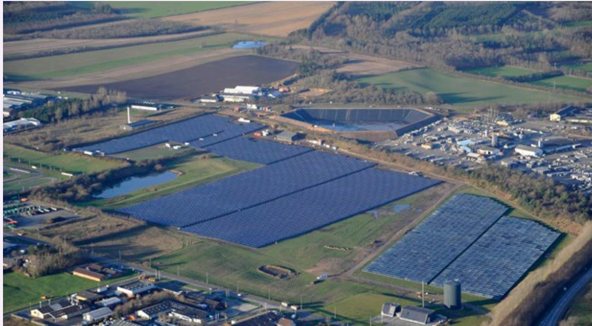
Solfangeranlæg ved fjernvarmeværket i Vojens dækker et stort areal. Foto: Vojens Fjernvarme
